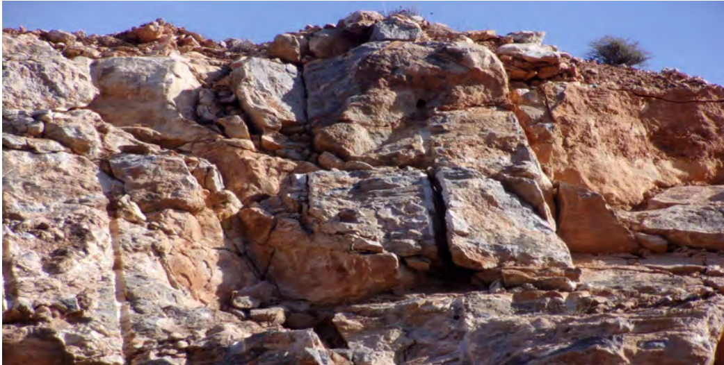
Zona superior coronación con rocas inestables
