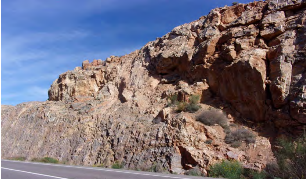
Inicio del tramo con inestabilidad de grandes bloques de roca
