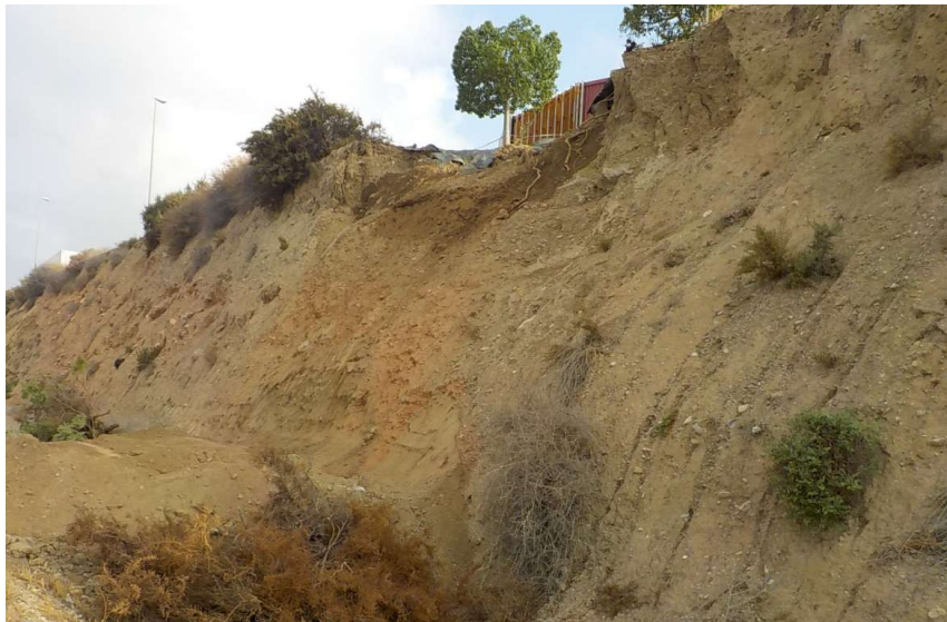
Vista del Talud y Desprendimientos en Cuneta
