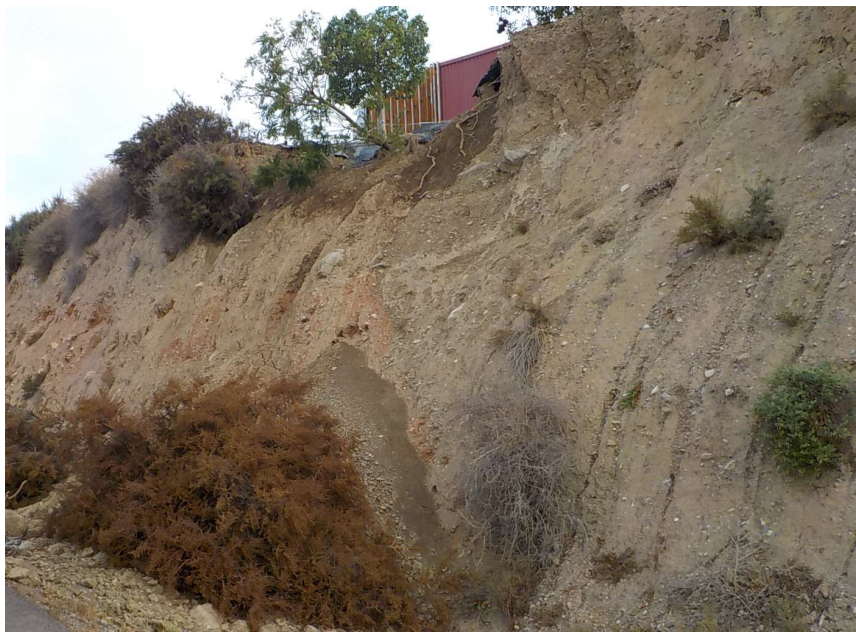
Vista de la oquedad producida en la coronación del terraplén
