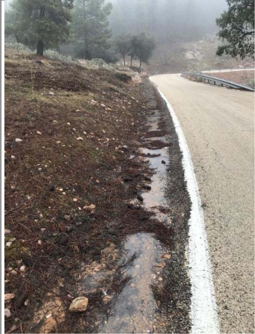
Foto 14.- Estado drenaje superficial
