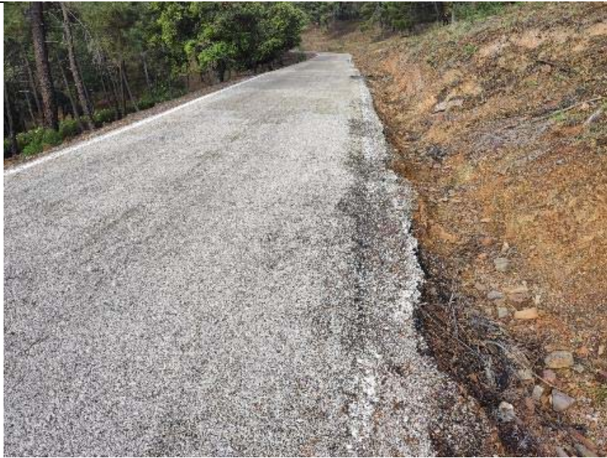
Foto 10.- Estado de firme y necesidad cuneta revestida P.K. 19+300
