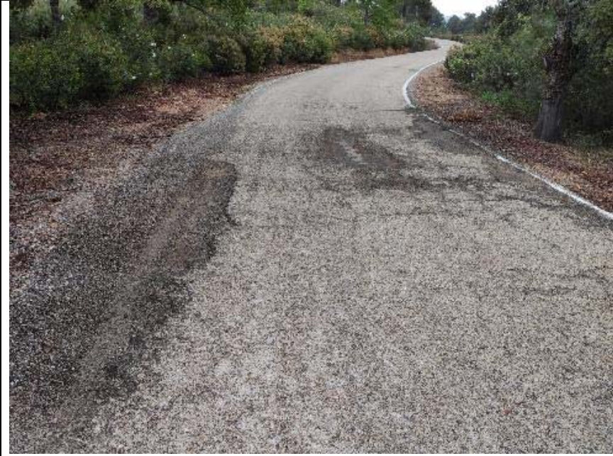
Foto 5.- Estado de firme P.K. 9+100
