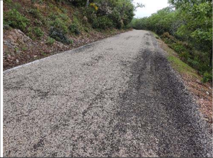
Foto 3.- Estado de firme P.K. 7+700
