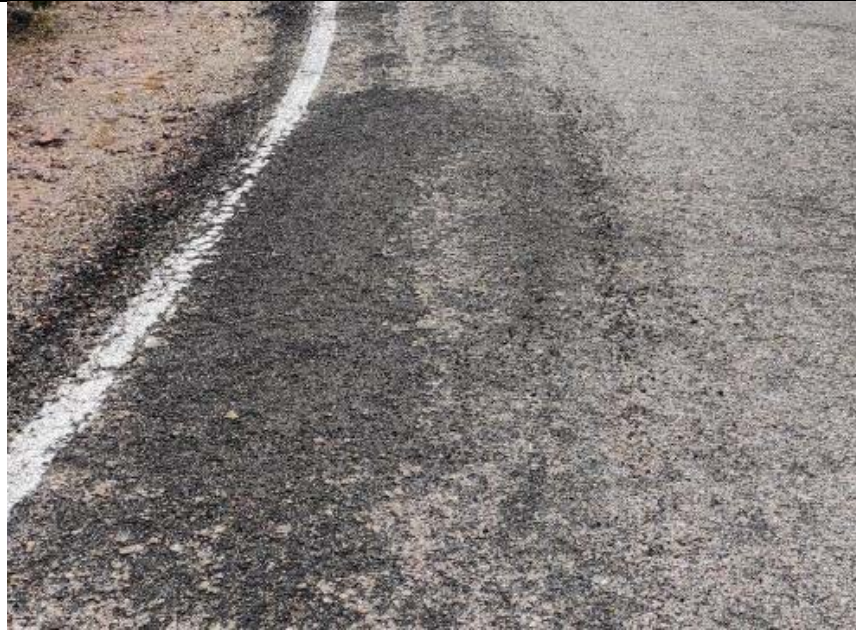
Foto 8.- Estado de firme P.K. 17+900
