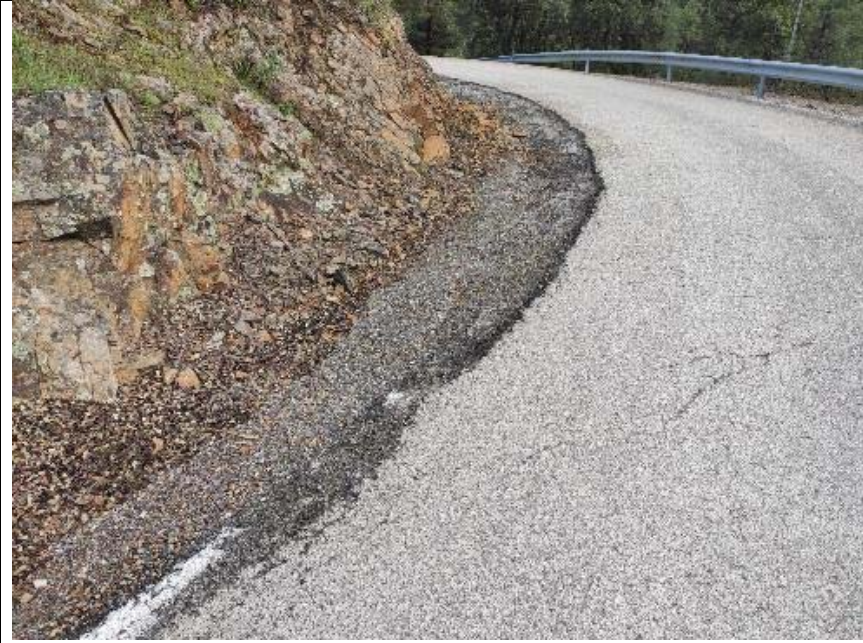
Foto 11.- Estado de firme y necesidad de cuneta revestida P.K. 19+500
