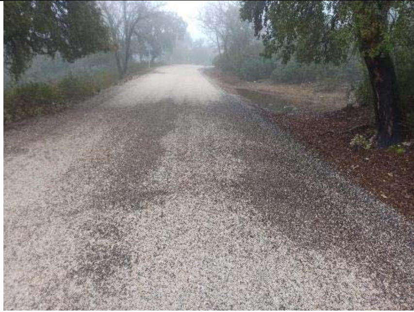
Foto 12.- Estado de firme y necesidad de cuneta revestida P.K 8+950
