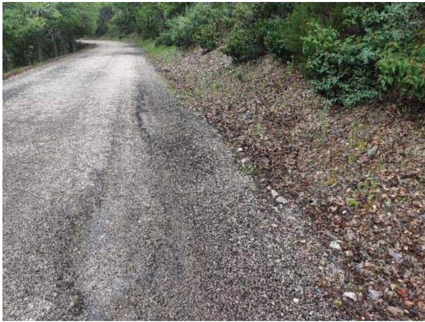
Foto 9.- Estado de firme y necesidad cuneta revestida P.K. 8+550
