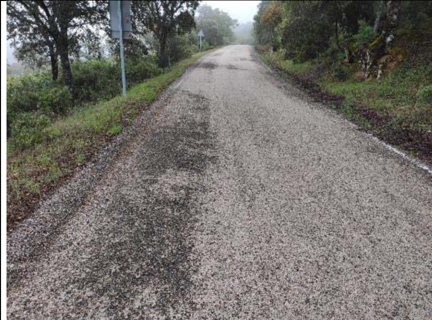
Foto 1.- Estado de firme P.K. 6+400
