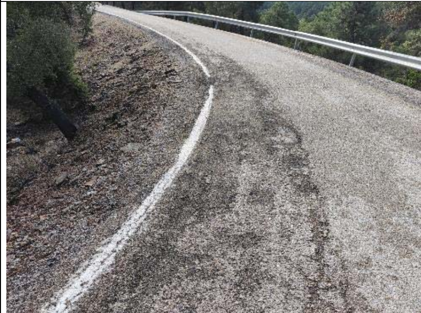
Foto 6.- Estado de firme P.K. 17+400
