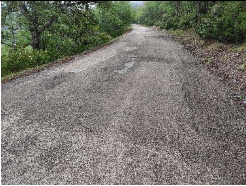
Foto 4.- Estado de firme P.K. 8+300
