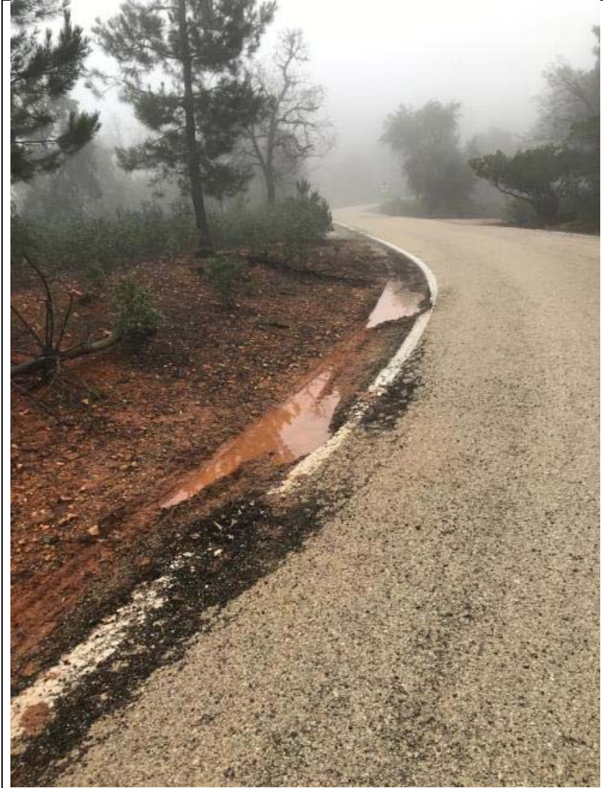
Foto 13.- Estado drenaje superficial
