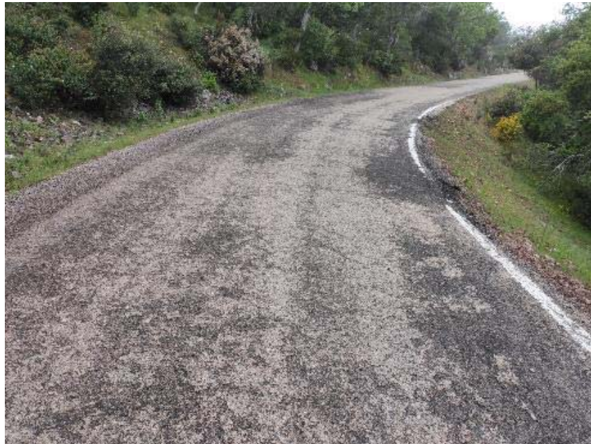
Foto 2.- Estado de firme P.K. 7+900
