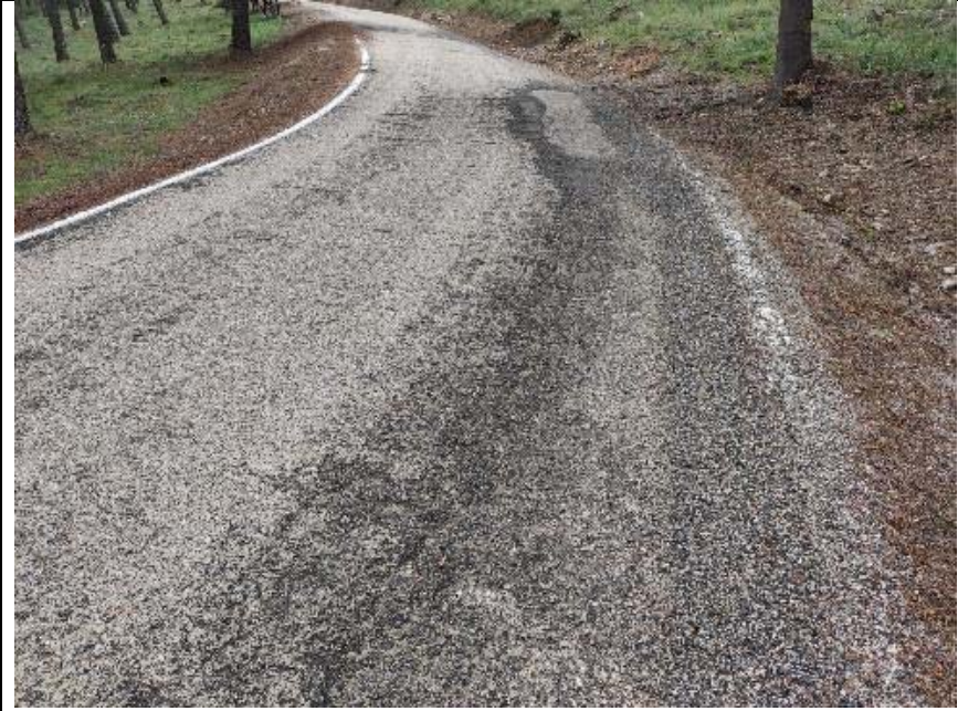
Foto 7.- Estado de firme P.K. 11+800
