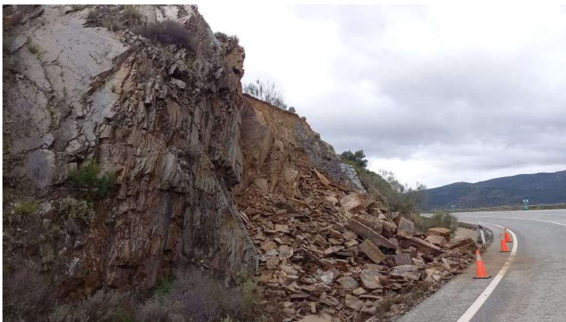
PK 32+750 MD, con terrenos inestables en cabeza de talud y desprendimientos sobre la cuneta y arcén.
