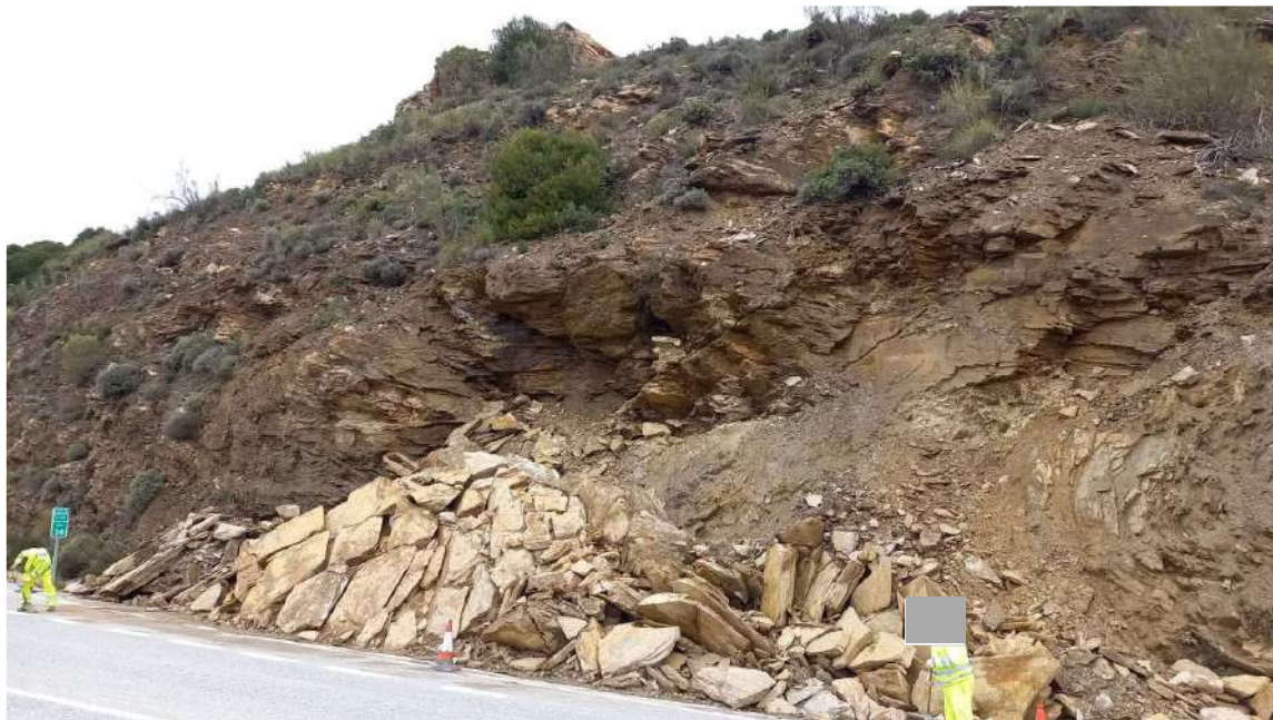
PK 36 MI, con rocas inestables en cabeza de talud y desprendimientos sobre la cuneta y arcén.
