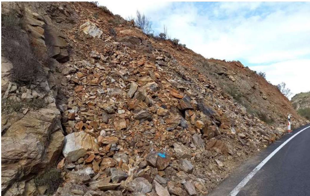
PK 30+900 MI, con cunetas aterradas por desprendimientos y ladera totalmente suelta
