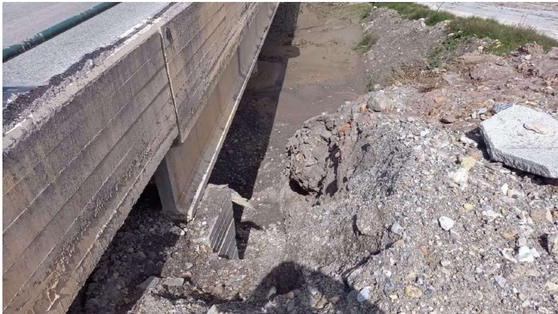
Daños en el estribo del puente producidos por la avenida
