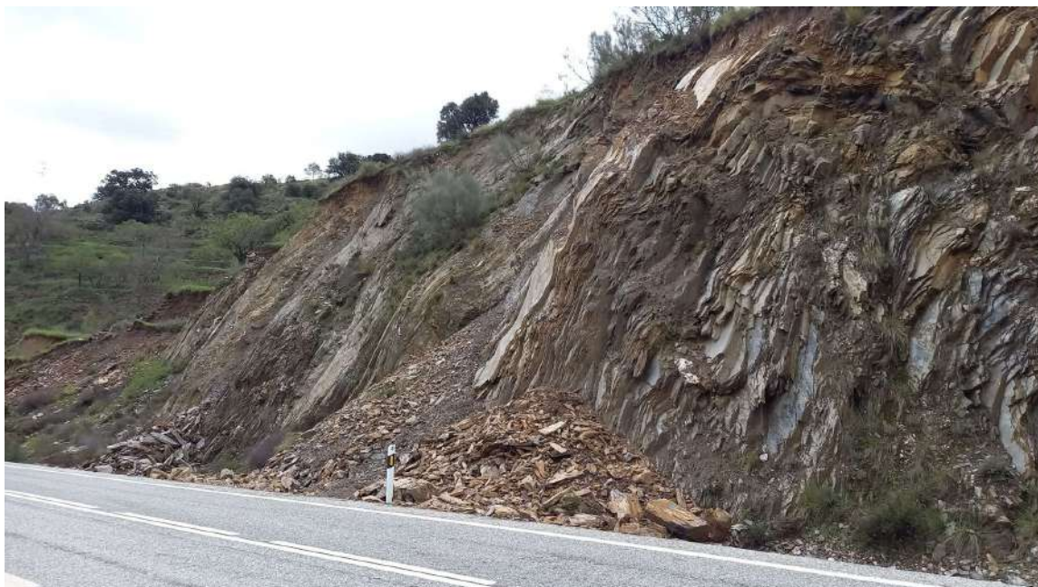
PK 32+250 MD, con talud inestable y desprendimientos sobre la cuneta y arcén.
