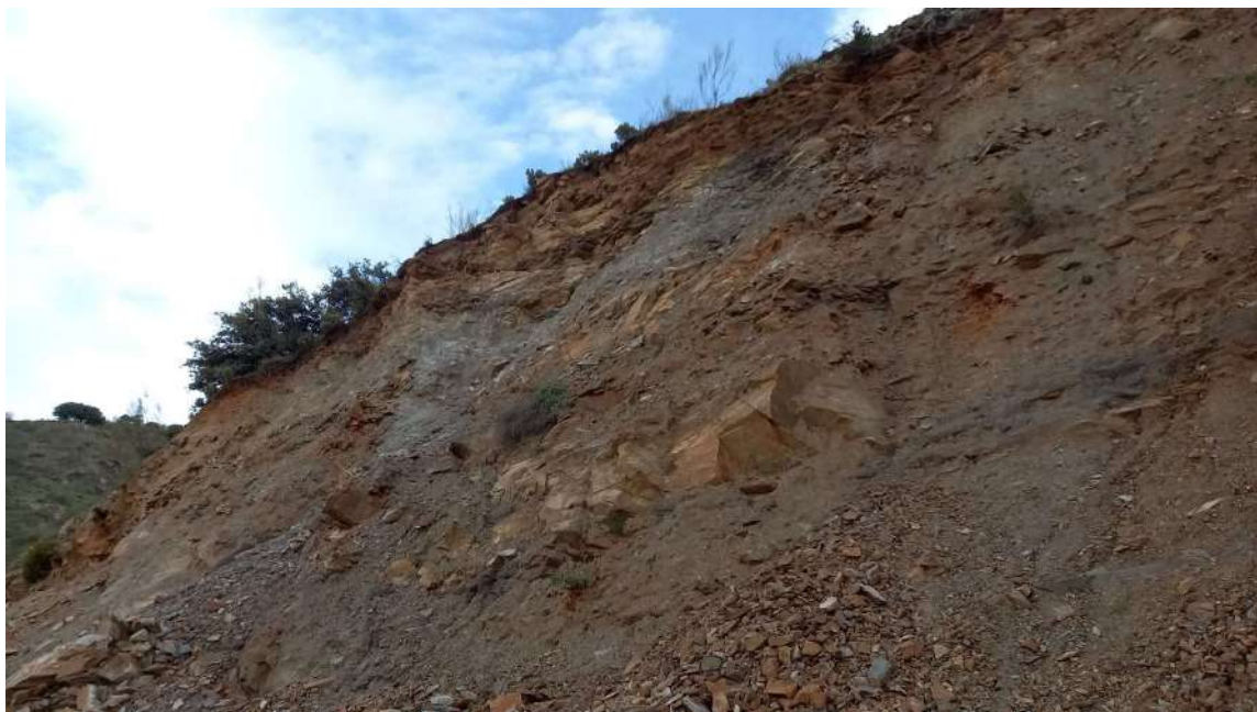
PK 30+950 MD, con talud inestable
