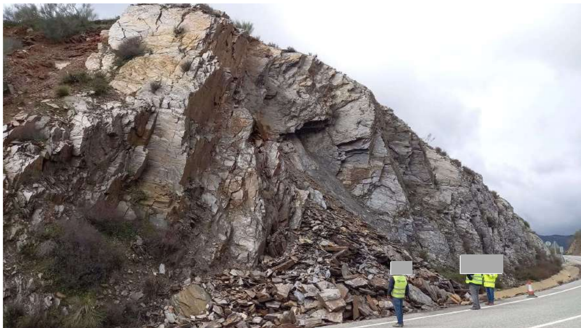
PK 34+050 MD, con rocas inestables en cabeza de talud y desprendimientos sobre la cuneta y arcén.
