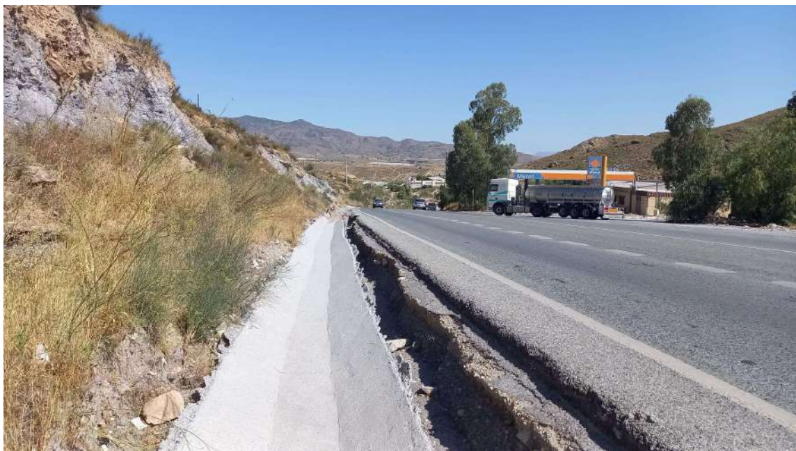
Estado actual de las cunetas del margen izquierdo
