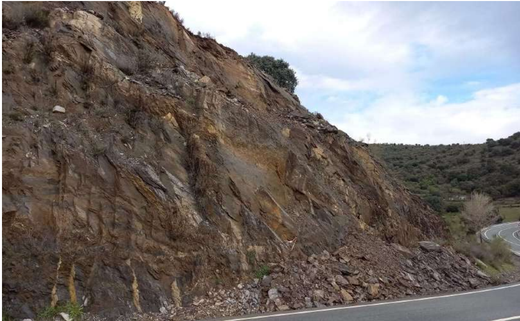
PK 26+600 MI, con cunetas aterradas por desprendimientos.
