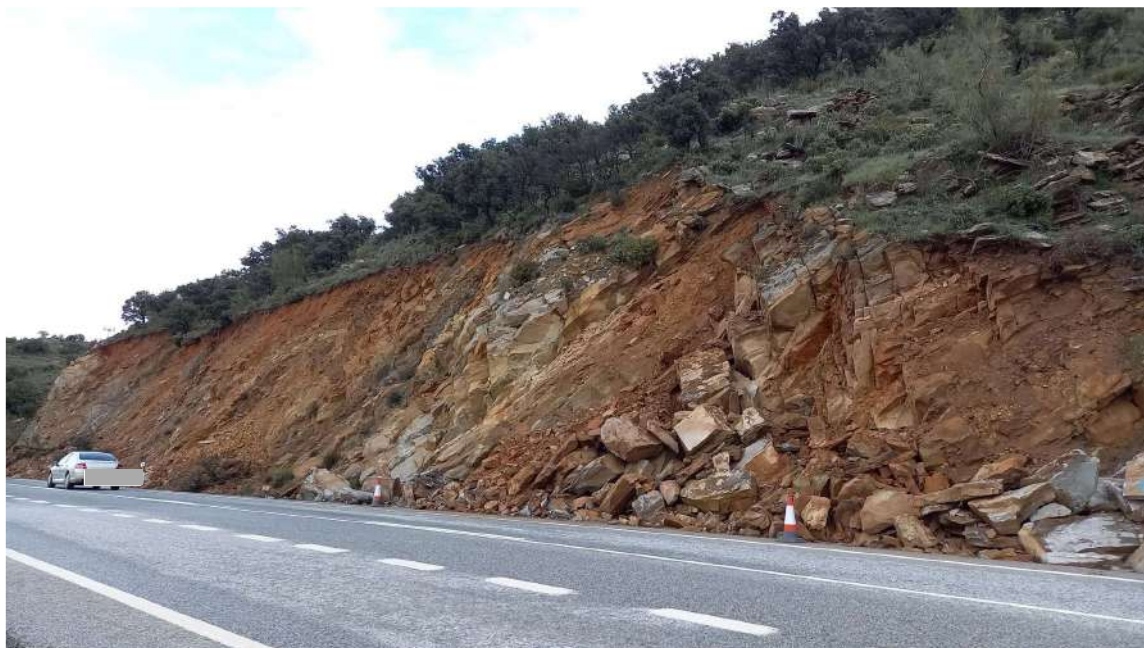
PK 32+150 MD, con talud inestable y desprendimientos sobre la cuneta y arcén.
