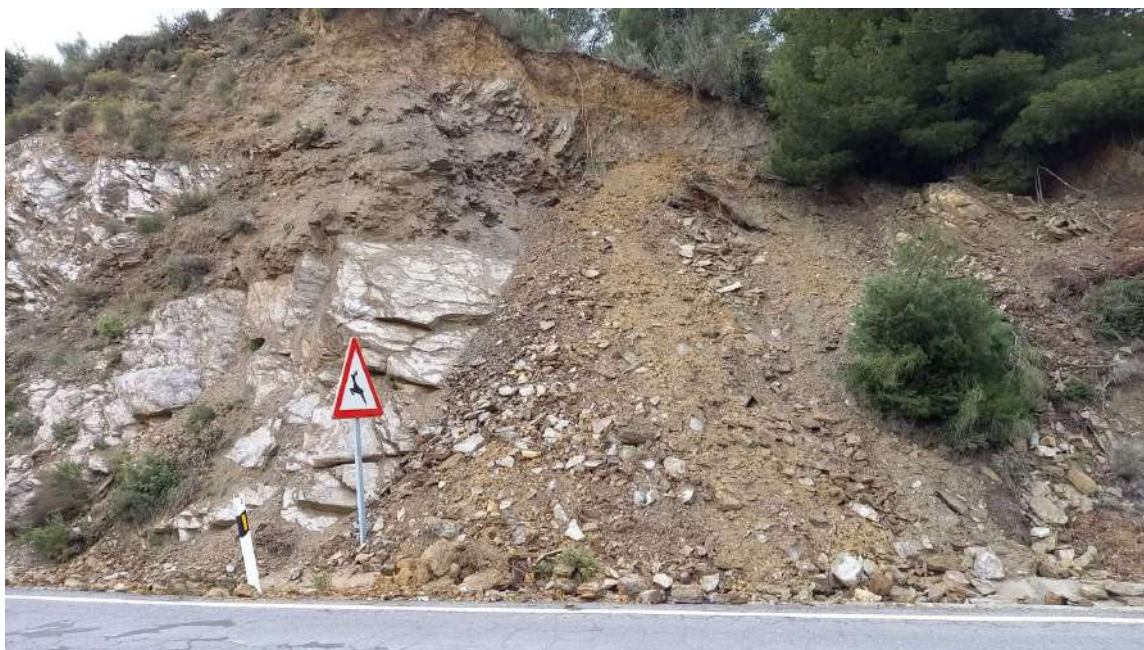
PK 36+300 MI, con terrenos inestables en cabeza de talud y desprendimientos sobre la cuneta y arcén.
