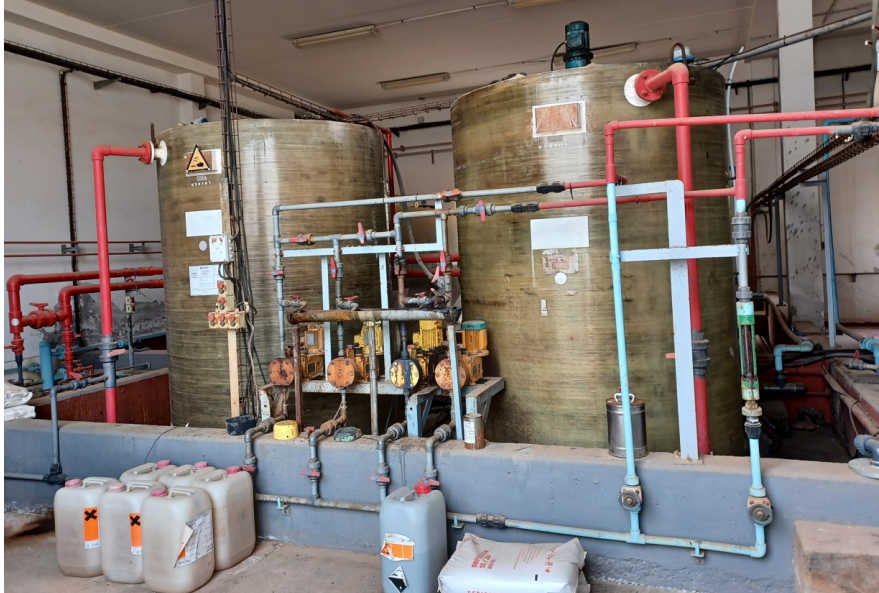
Instalación de dosificación de coagulante
