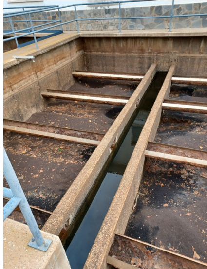
Aspecto de uno de los filtros
