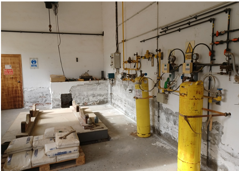
Instalación de cloro-gas
