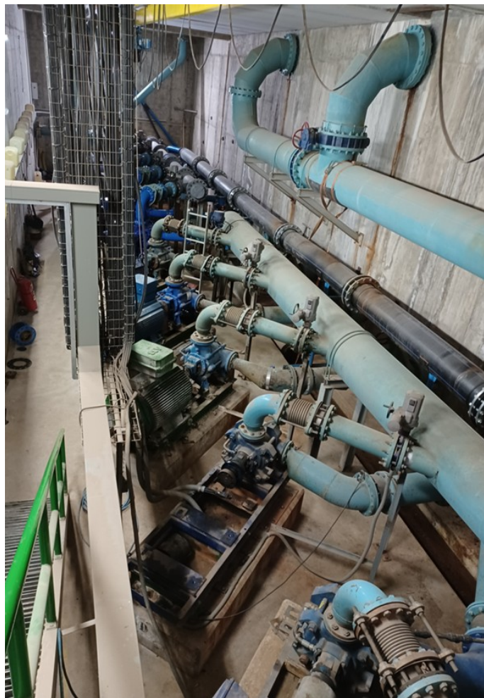
Bombeo de agua tratada
