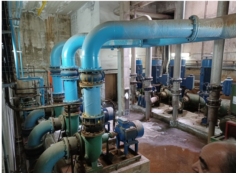
Sótano bajo edificio de filtros. En primer término se aprecian las bombas de lavado de filtros. Al fondo las bombas de alta presión
