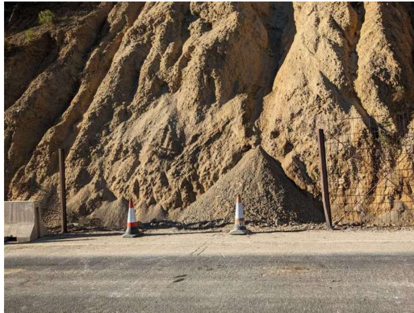
Imagen 4. Vista de los desprendimientos ocurridos en las 10 horas posteriores a la limpieza del desprendimiento inicial.
