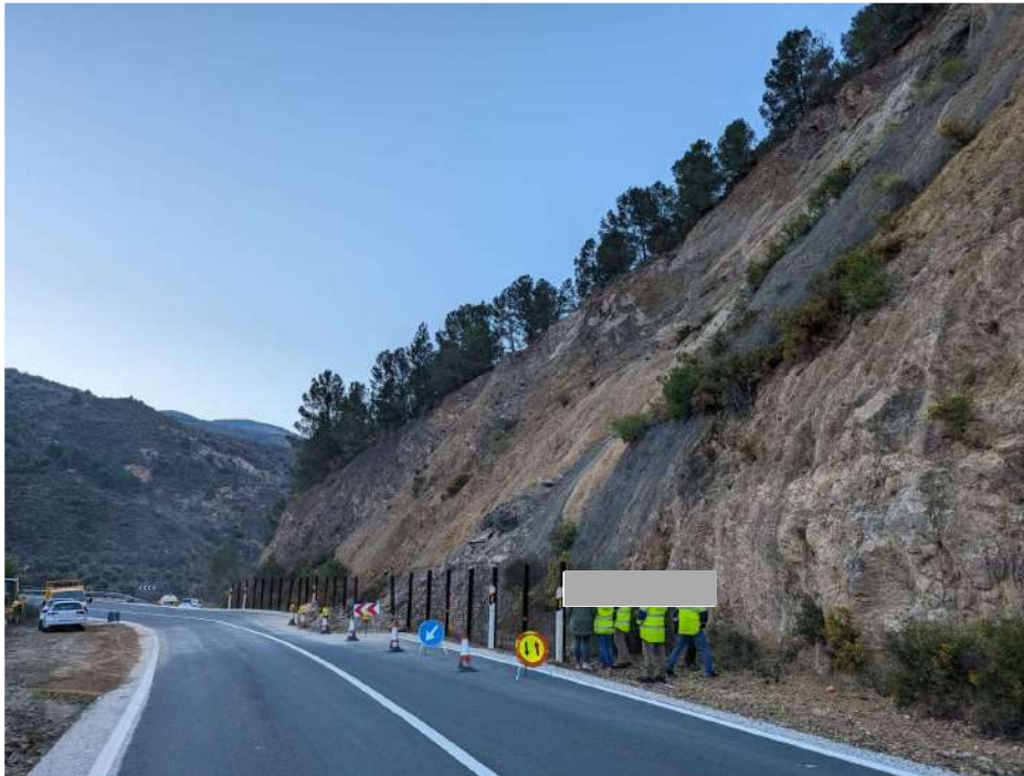
Imagen 2. Vista de la calzada tras la limpieza inicial.
