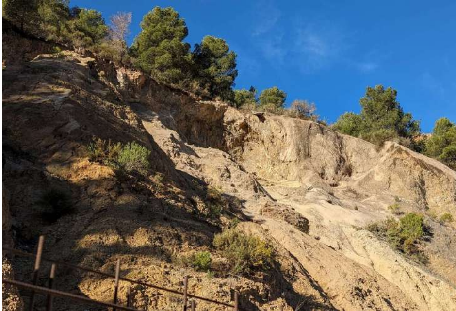
Imagen 1. Vista de la parte alta del macizo tras los desprendimientos.
