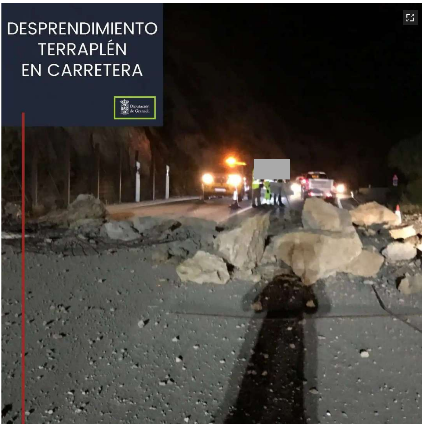
Imagen del desprendimiento.
