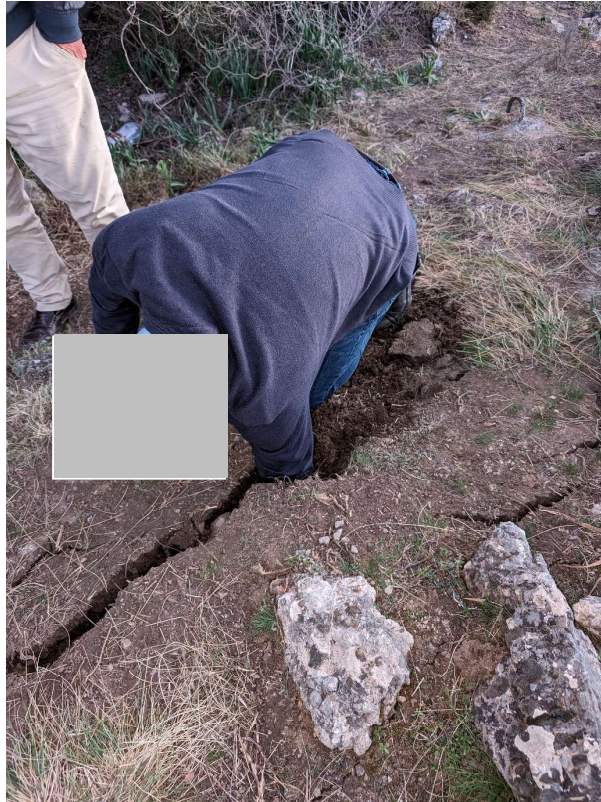
Imagen 3. Grietas en cabeza de talud (2).
