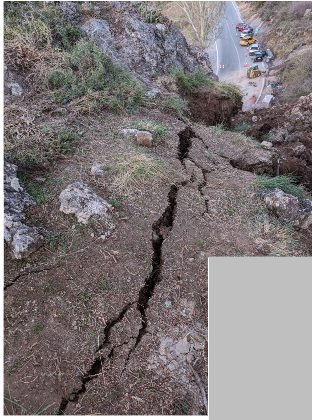
Imagen 2. Grietas que aparecieron en cabeza del deslizamiento una vez comenzadas las obras, y que inicialmente no estaban.
