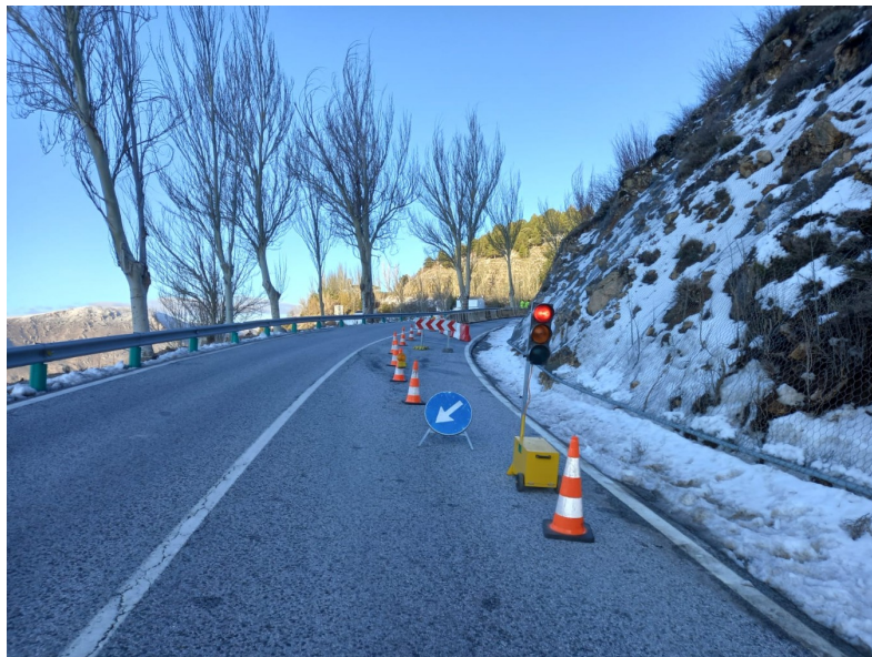
Imagen 4. Instalación de semáforos para regular el paso alternativo de vehículos.
