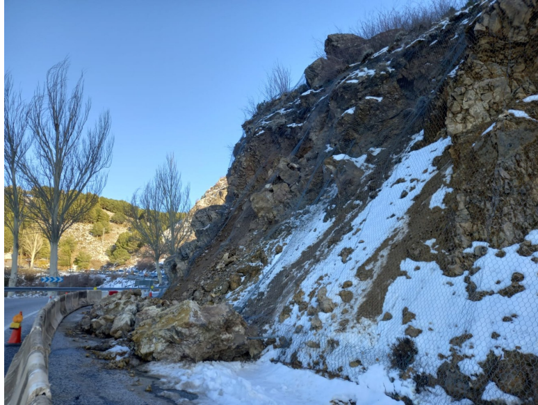
Imagen 3. Cordón de rocas y barrera new jersey como protección frente a nuevas caídas de rocas.
