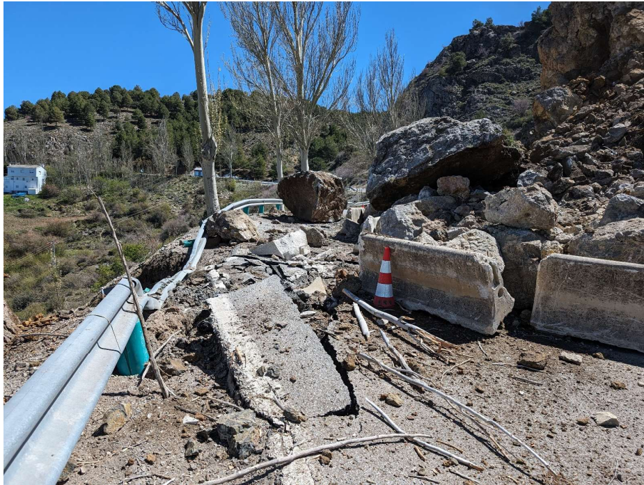
Imagen 1. Rotura de calzada provocada por la caída de rocas.
