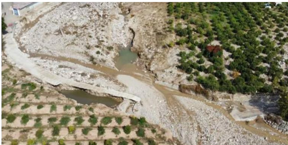
Imagen tomada con dron de la zona afectada cedida por el Servicio de Infraestructuras.
